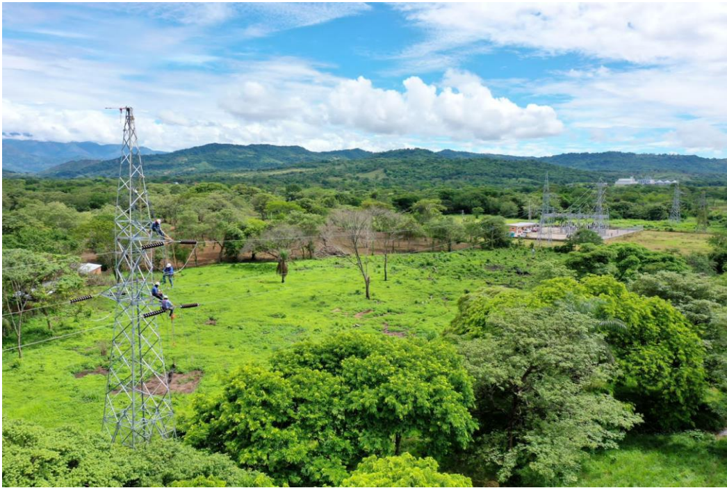
Torre 117 en la línea de Yopal – La Yopalosa
