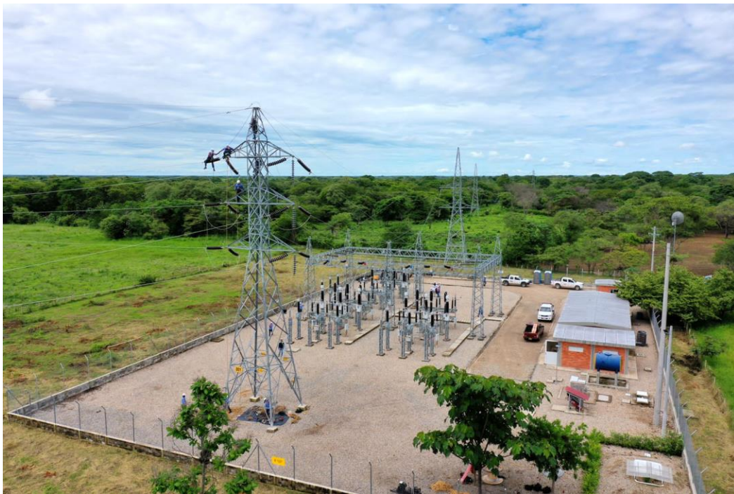
Subestación de La Yopalosa. Nunchía, Casanare
