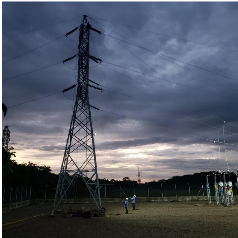
Torre 1 Ubicada en la subestación de La Yopalosa
