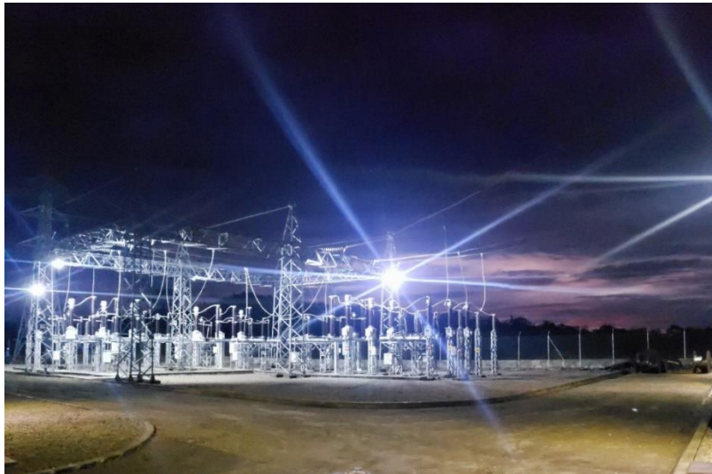
Subestación de La Yopalosa. Nunchía, Casanare
