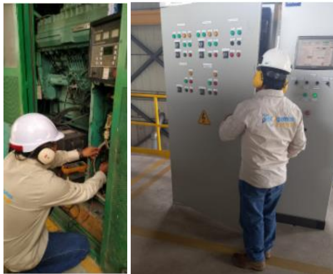
Labores de rutina de operación y mantenimiento
