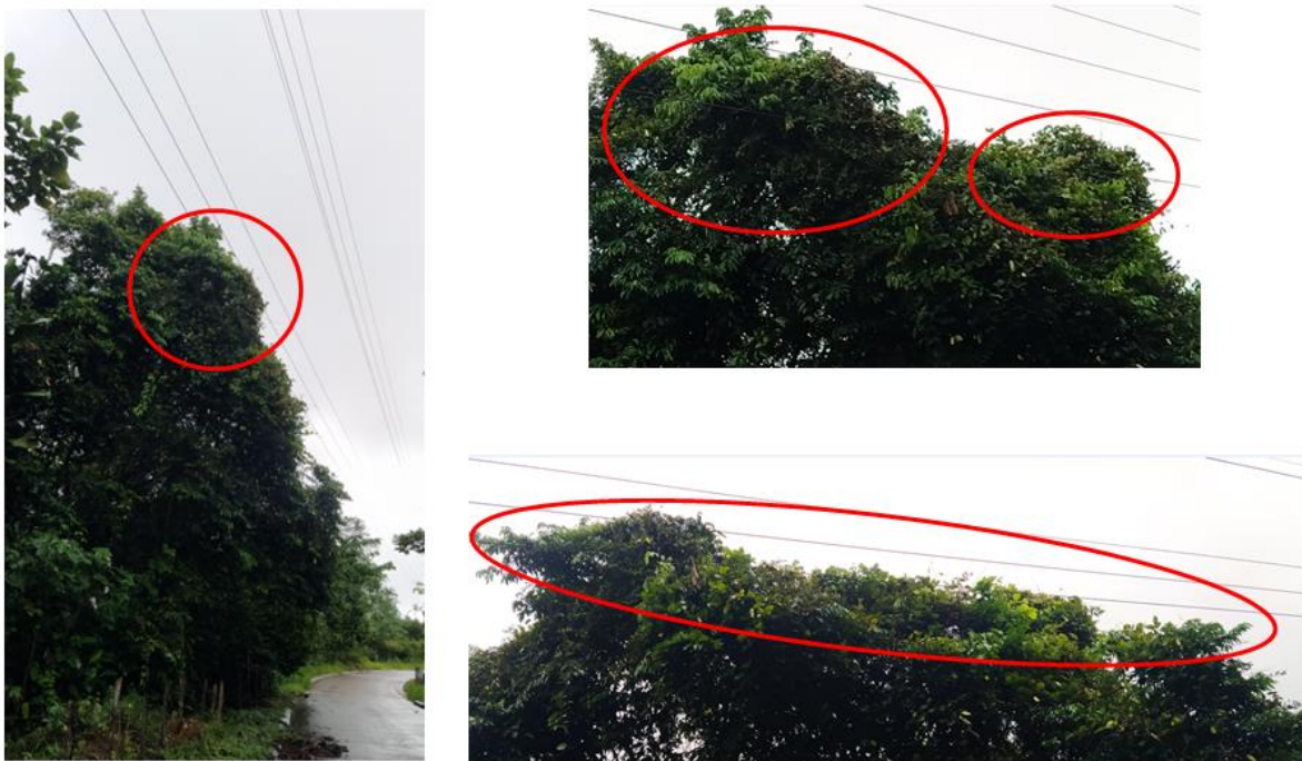
Contacto vegetal sobre la línea de transmisión 34,5 kV
